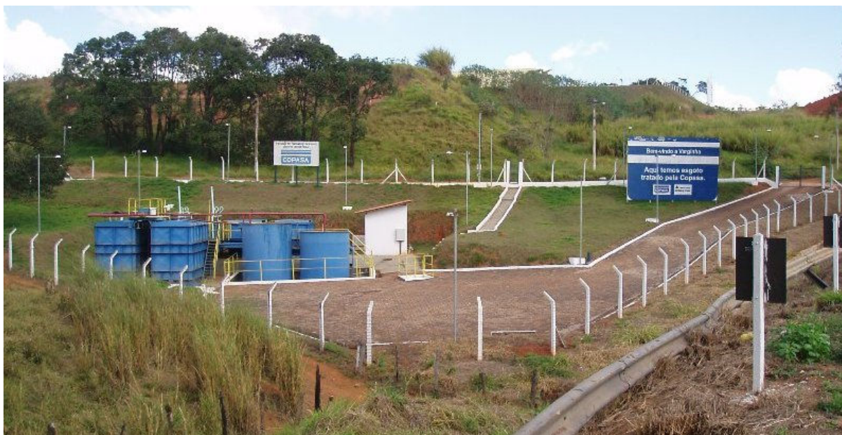
Figura 124 – Estação de tratamento de esgoto do distrito industrial de Varginha.
