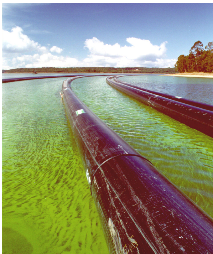
Figura 157 - Represas Billings, Taquacetuba e Guarapiranga em São Paulo - Captação flutuante para reduzir o aporte de cianobactérias na água a ser tratada.
