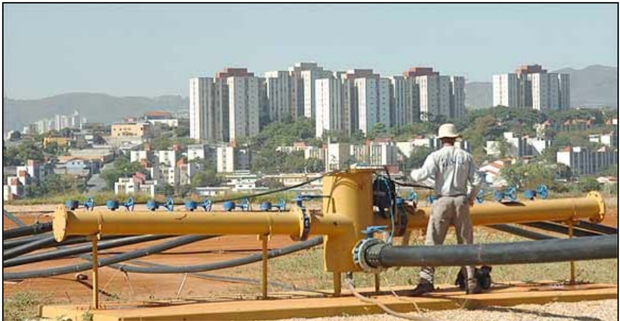
Figura 8.12 - Usina de biogás para eletricidade no aterro da BR 040 em Belo Horizonte (5MW).
