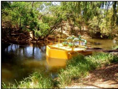
Montalvânia - Captação em balsa
