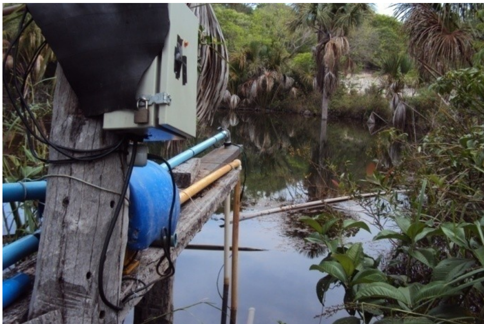
Figura 5.3 - Captação para abastecimento do distrito Vila Serrana.
