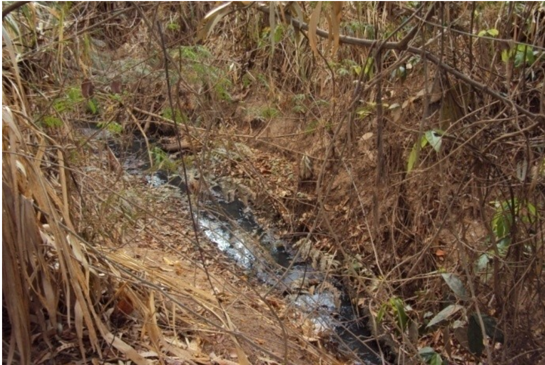
Figura 5.99 - Esgotamento sanitário residencial in natura da sede urbana de Bonfinópolis de Minas. Fonte: Consórcio Ecoplan-Lume-Skill, 2011.
