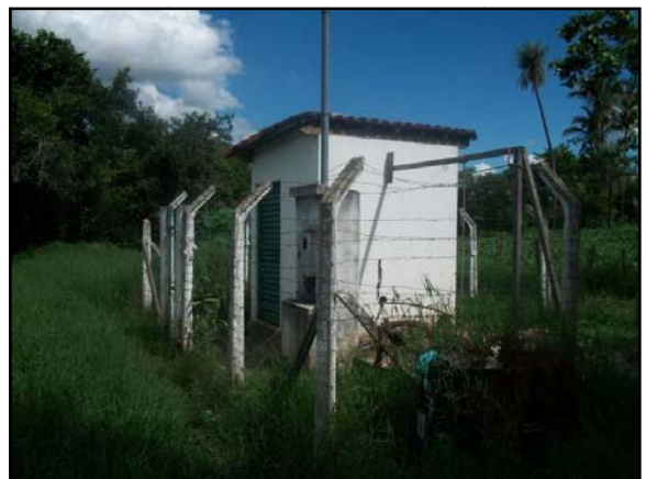
Urucuia – Estação de Bombeamento paralisada
