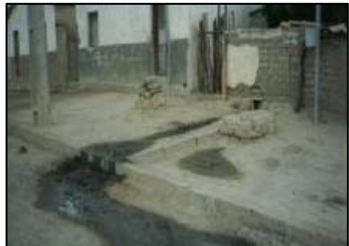
Esgoto à céu aberto
