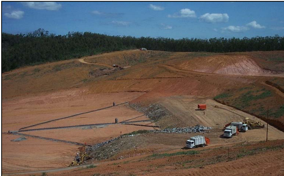
Figura 8.7 - Aterro sanitário. (Fonte: FEAM).
