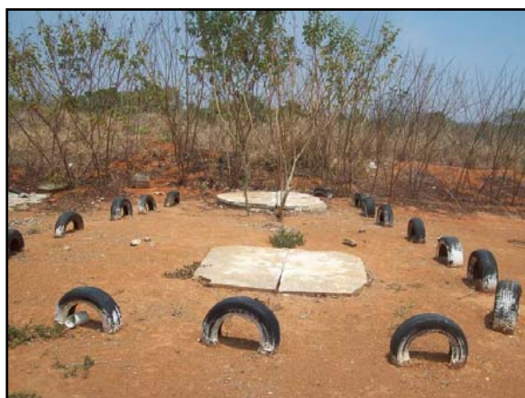
Arinos – Fossa e sumidouro para tratamento do chorume
