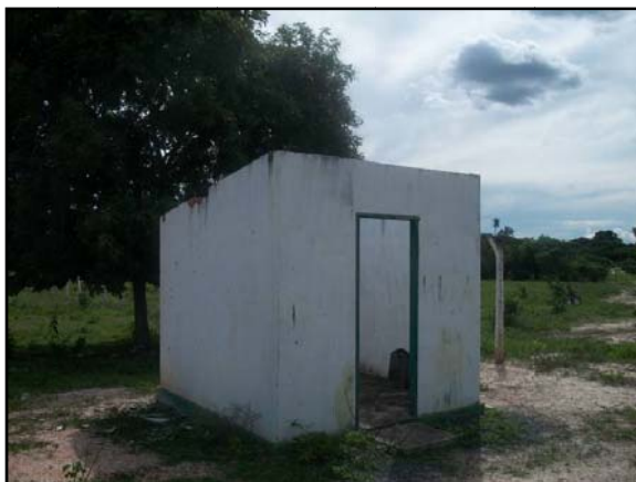
Urucuia – Unidade de apoio operacional da ETE sem condição de funcionamento
