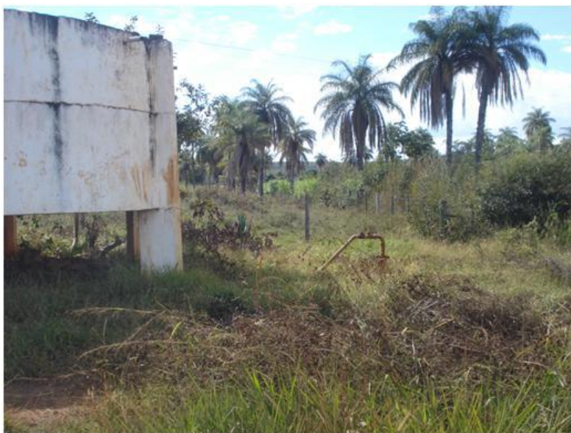
Figura 48 – Poço tubular profundo e reservação de água, distrito de Ermidinha em Montes Claros
