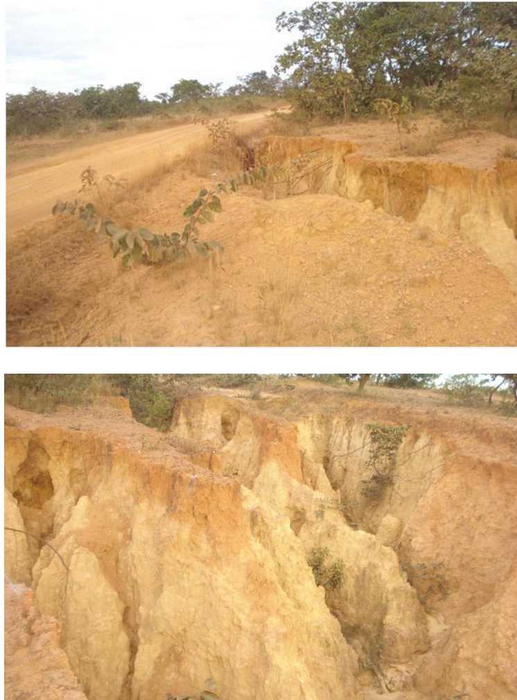
Figura 56 – Erosão na estrada em São Roberto de Minas – São João da Lagoa
