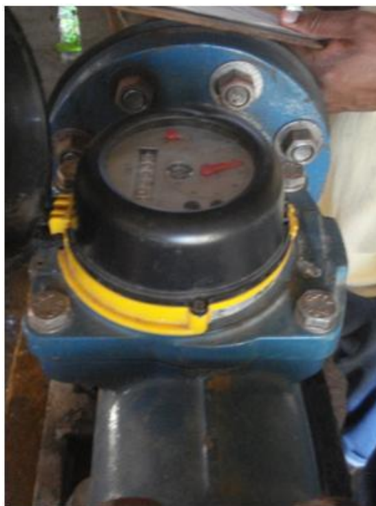
Figura 64 – Horímetros instalados nos sistemas de captação de água
