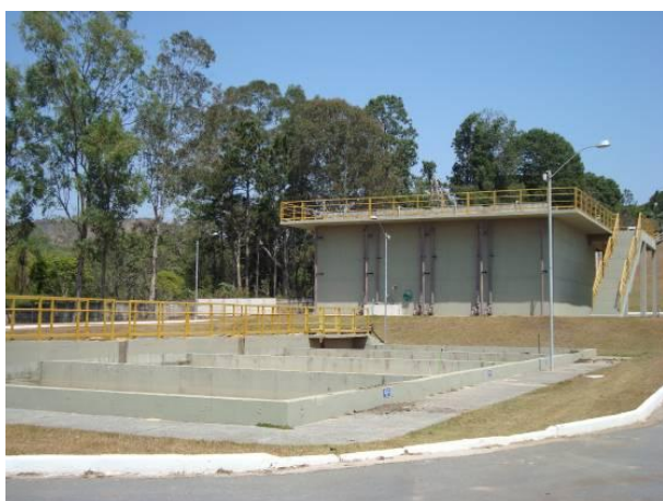
Figura 114 - Estação de Tratamento de efluentes da sede municipal de São João Del Rei (Bairro Colônia do Marçal).
