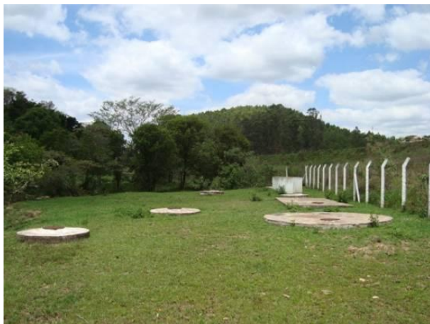
Figura 224 - Estação de tratamento de esgoto da sede municipal de Cana Verde.
