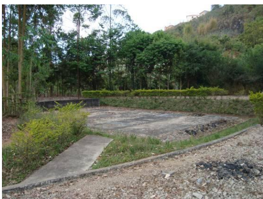
Figura 34 - Estação de tratamento de esgoto do distrito de Senhora das Dores (Barbacena).
