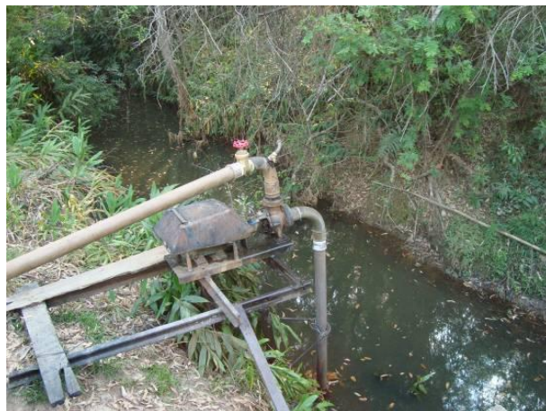
Figura 122 - Ponto de captação para o abastecimento doméstico e industrial da sede municipal de São João Del Rei, córrego Altamiro Braga.
