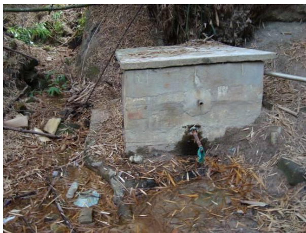
Figura 131 - Captação para o abastecimento doméstico do povoado rural Prainha (Ritápolis). Fonte: EcoPLAN-Lume-Skill, 2011.
