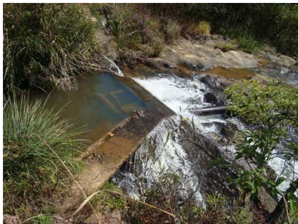
Figura 45 - Ponto de captação para abastecimento doméstico e industrial da sede municipal de Antônio Carlos.
