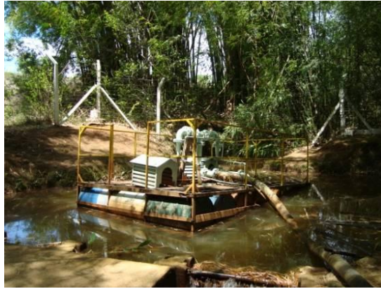
Figura 186 - Ponto de captação para o abastecimento doméstico do povoado rural Palmital do Cervo (Carmo da Cachoeira).
