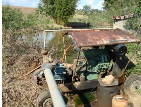
Figura 177 - Ponto de captação para irrigação por aspersão.
