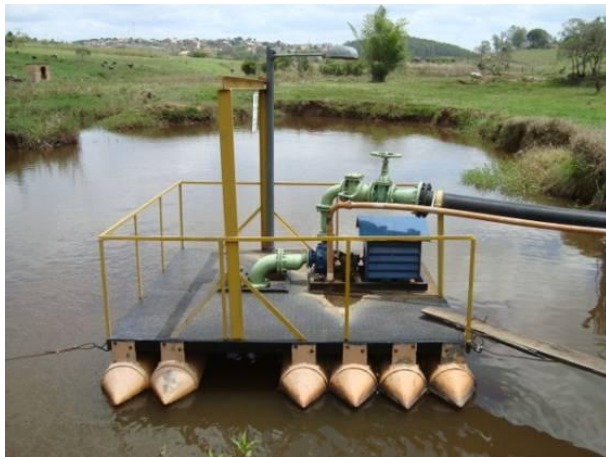
Figura 222 - Em destaque a balsa de captação para o abastecimento doméstico e industrial da sede municipal de Cana Verde.
