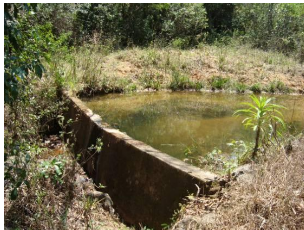
Figura 76 - Ponto de captação para o abastecimento doméstico e industrial da localidade rural de Bichinho (Prados).
