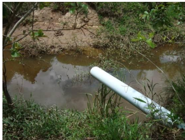
Figura 225 - Ponto de lançamento de efluentes tratados da sede municipal de Cana Verde.
