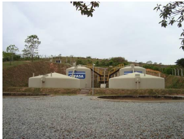
Figura 141 - Estação de tratamento de efluentes da sede municipal de Conceição da Barra de Minas.
