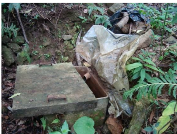
Figura 173 - Ponto de captação para o abastecimento doméstico da sede municipal de Ijaci (somente o bairro Vila Industrial).
