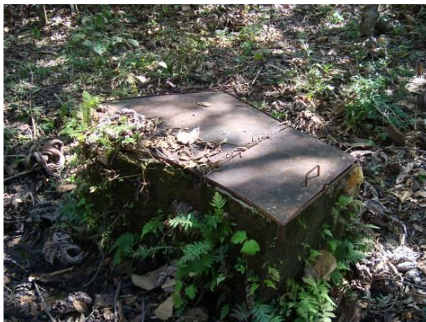
Figura 44 - Ponto de captação para abastecimento doméstico do distrito de Pinheiro Grosso (Barbacena).
