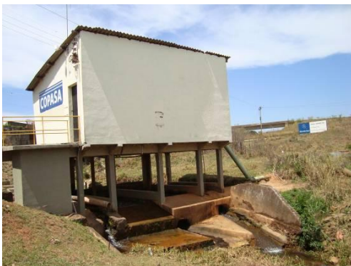
Figura 48 - Ponto de captação para o abastecimento doméstico e industrial da sede municipal de Barbacena.
