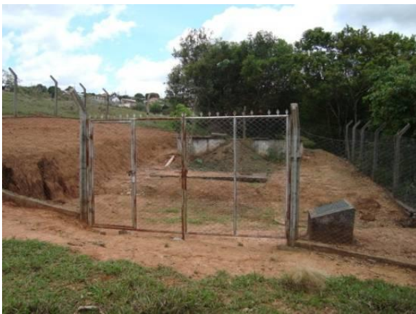
Figura 187 - Filtro para retirada dos resíduos sólidos provenientes dos efluentes domésticos do povoado rural Palmital do Cervo (Carmo da Cachoeira).
