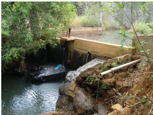
Figura 68 - Ponto de captação para abastecimento doméstico e industrial da sede municipal de Dores de campos.
