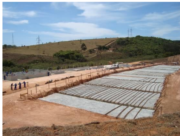
Figura 51 - Obras da estação de tratamento de efluentes da sede municipal de Barbacena.
