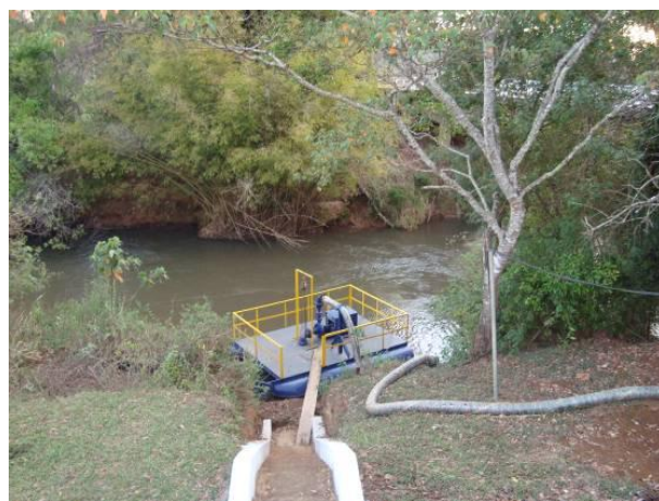
Figura 103 - Em destaque a balsa de captação para o abastecimento doméstico e industrial da sede municipal de Tiradentes.
