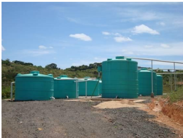
Figura 212 - Estação de tratamento de esgoto da sede municipal de Santo Antônio do Amparo.
