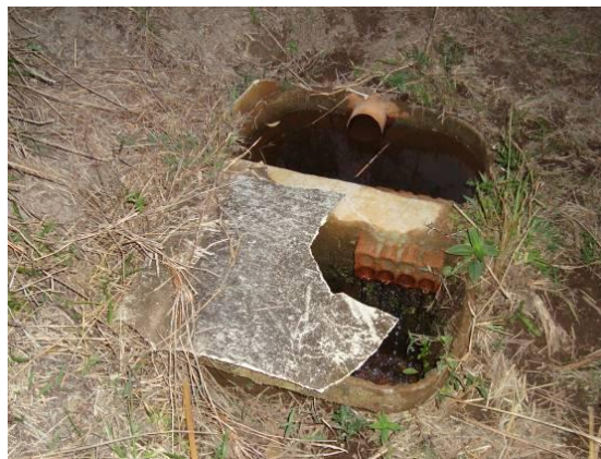
Figura 196 - Ponto de captação para o abastecimento doméstico e industrial do povoado rural Içara (São Tiago), localizado no córrego Sipião.
