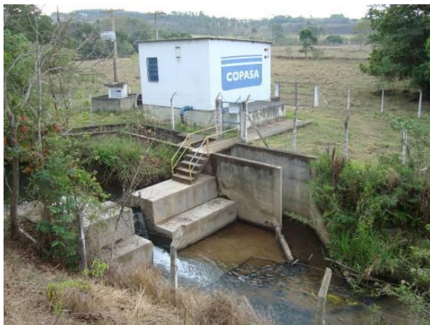
Figura 52 - Captação para o abastecimento doméstico e industrial da sede municipal de Barroso.
