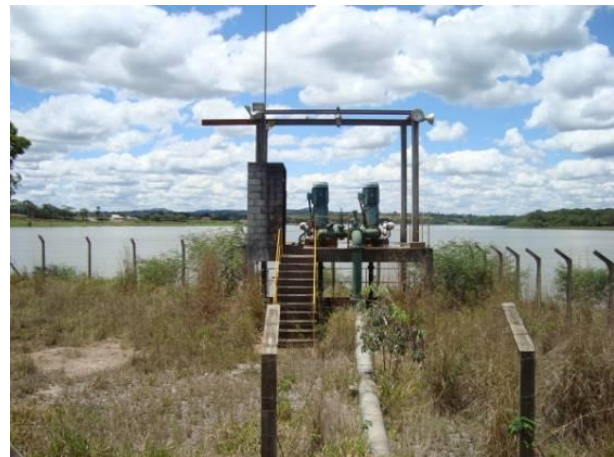
Figura 166 - Ponto de captação para o abastecimento industrial.
