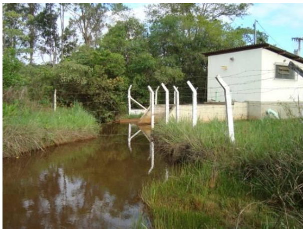
Figura 207 - Ponto de captação para o abastecimento doméstico e industrial da sede municipal de São Francisco de Paula.
