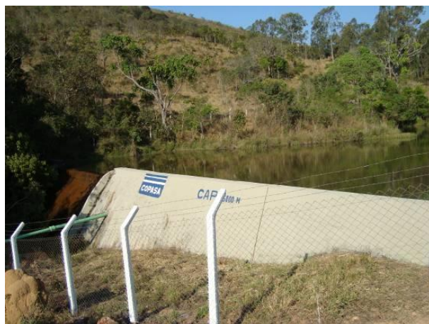
Figura 65 - Ponto de captação para o abastecimento doméstico e industrial da sede municipal de Ressaquinha.
