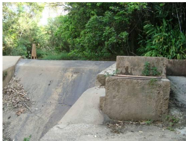
Figura 121 - Ponto de captação para o abastecimento doméstico e industrial da sede municipal de São João Del Rei, córrego Rio Acima.
