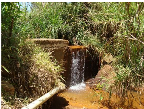
Figura 143 - Ponto de captação para o abastecimento doméstico da localidade rural denominada Januário (São João Del Rei).
