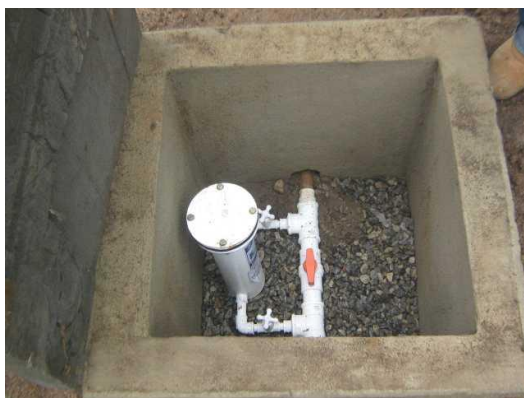
Exemplo de montagem na EE Lavra do Roque – Santo Antônio do Jacinto - MG
