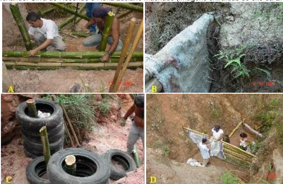
Figura 92 - (A) encaixe canaleta no leito da voçoroca e amarrão dos bambus; (B) Detalhe do encaixe dos bambus no barranco lateral; (C) construção de paliçada utilizando pneus usados; (D) colocação de sacos de rafia.
