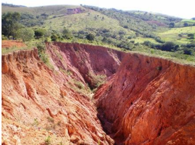
Figura 106 - Erosão no município de São João del Rei.
