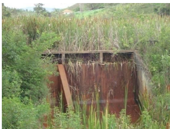
Figura 62 - Barramento do reservatório destinado a captação para abastecimento doméstico da sede municipal de Seritinga, local tomado por vegetação aquática emergente e bastante assoreado.
