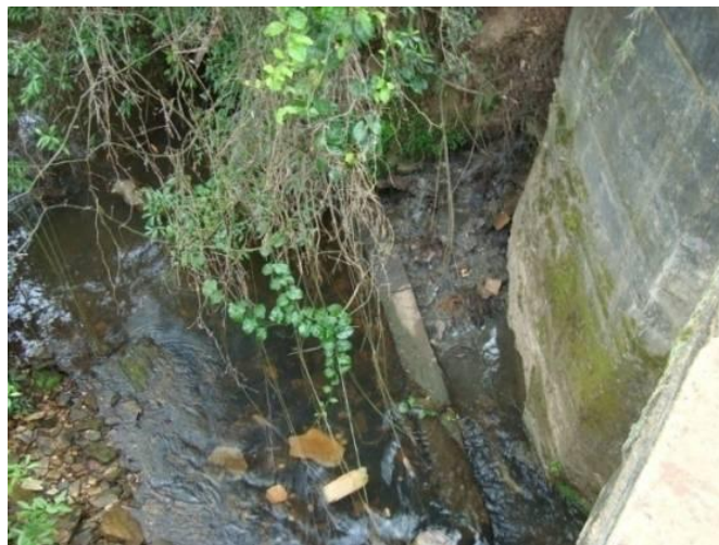
Figura 76 - Ponto de lançamento de efluentes domésticos da localidade rural do Sobradinho (São Thomé das Letras).
