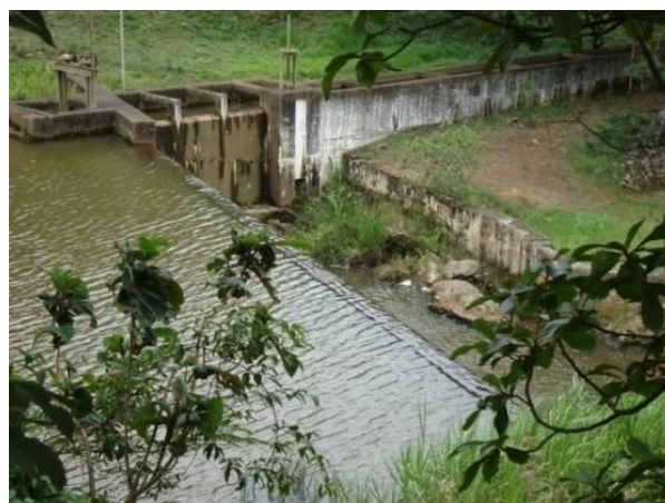
Figura 55 - Barramento PCH inoperante. Fonte: Ecoplan-Lume-Skill, 2011.
