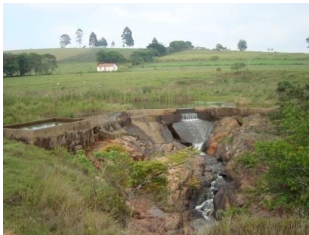
Figura 145 - Ponto de captação para abastecimento doméstico e industrial da sede municipal de Nazareno.
