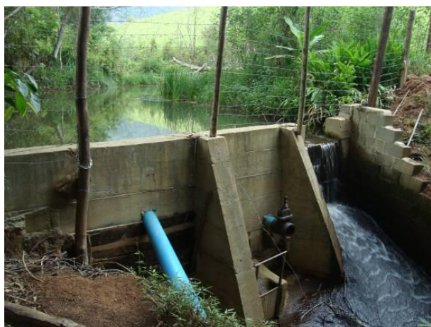
Figura 44 - Ponto de captação para o abastecimento público da sede municipal de Aiuruoca.
