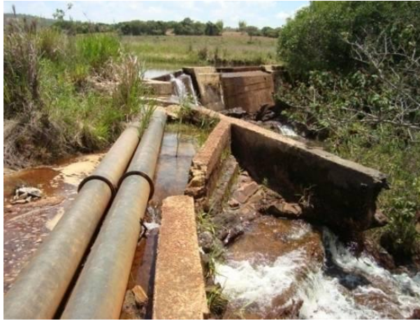
Figura 137 - Ponto de captação para abastecimento doméstico e industrial da sede municipal de Itutinga.
