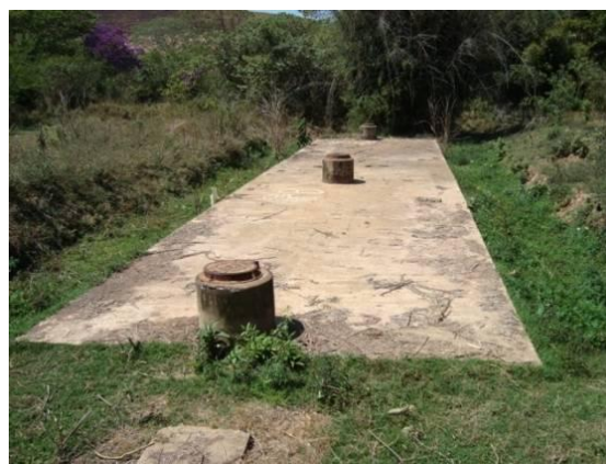
Figura 126 - Estação de tratamento de esgoto da sede municipal de Madre de Deus de Minas.
