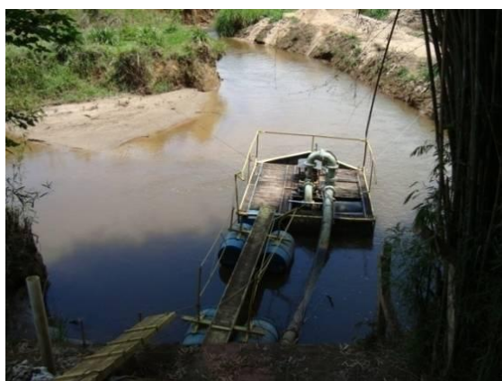
Figura 51 – Em destaque a balsa de captação para abastecimento doméstico da sede municipal de Carvalhos (rio Francês).
