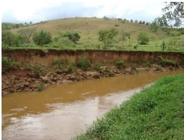
Figura 60 - Ponto de lançamento de esgoto da sede municipal de Andrelândia, em destaque a quase total inexistência de vegetação ciliar no local, o que vem a ser uma das principais causas dos desbarrancamentos das margens e conseqüentemente o assoreamento do curso d'água.
