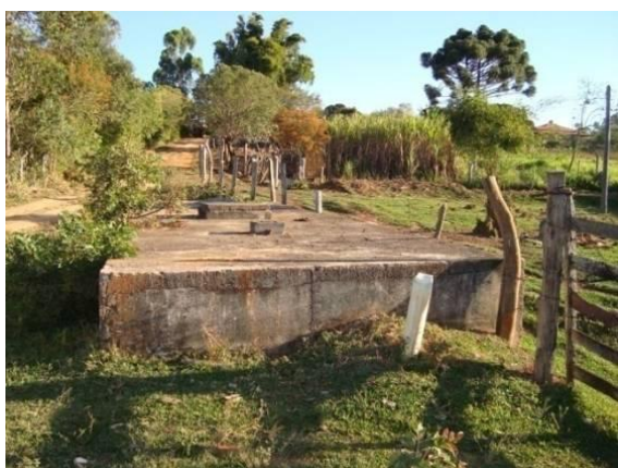
Figura 118 - Estação de tratamento de esgoto da localidade rural Jardim (Piedade do Rio Grande).
