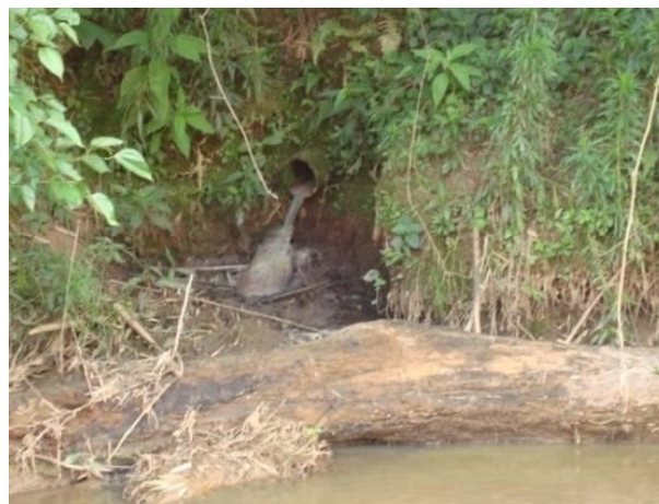
Figura 42 - Ponto de lançamento de esgoto da sede de Alagoa diretamente no ribeirão Vermelho.
