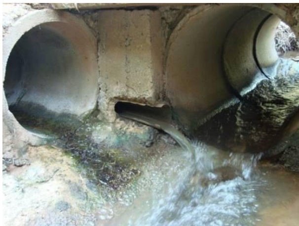
Figura 82 - Ponto de lançamento de efluentes domésticos e industriais da sede municipal de Ingai.
