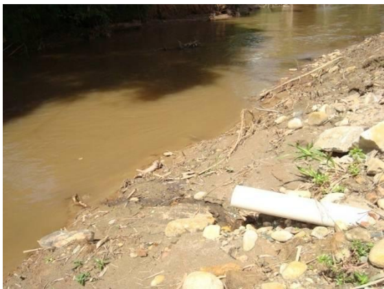
Figura 27 - Ponto de lançamento de esgoto bruto da sede municipal de Alagoa.
