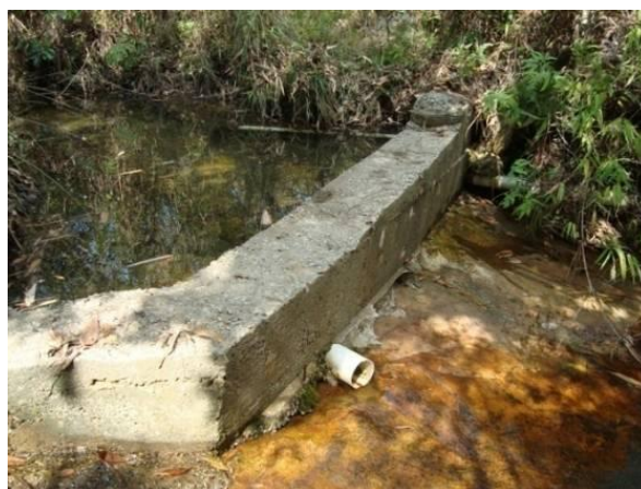
Figura 90 - Ponto de captação para abastecimento doméstico do povoado rural de Estação de Carrancas.
