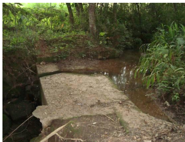
Figura 45 - Ponto de captação para o abastecimento público da sede municipal de Aiuruoca.
