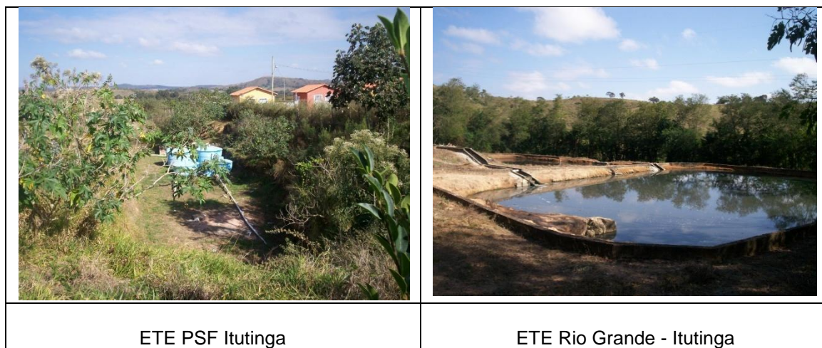
Figura 55 – Estações de Tratamento de Esgotos de Itutinga – único sistema com tratamento para 100% do esgoto coletado
