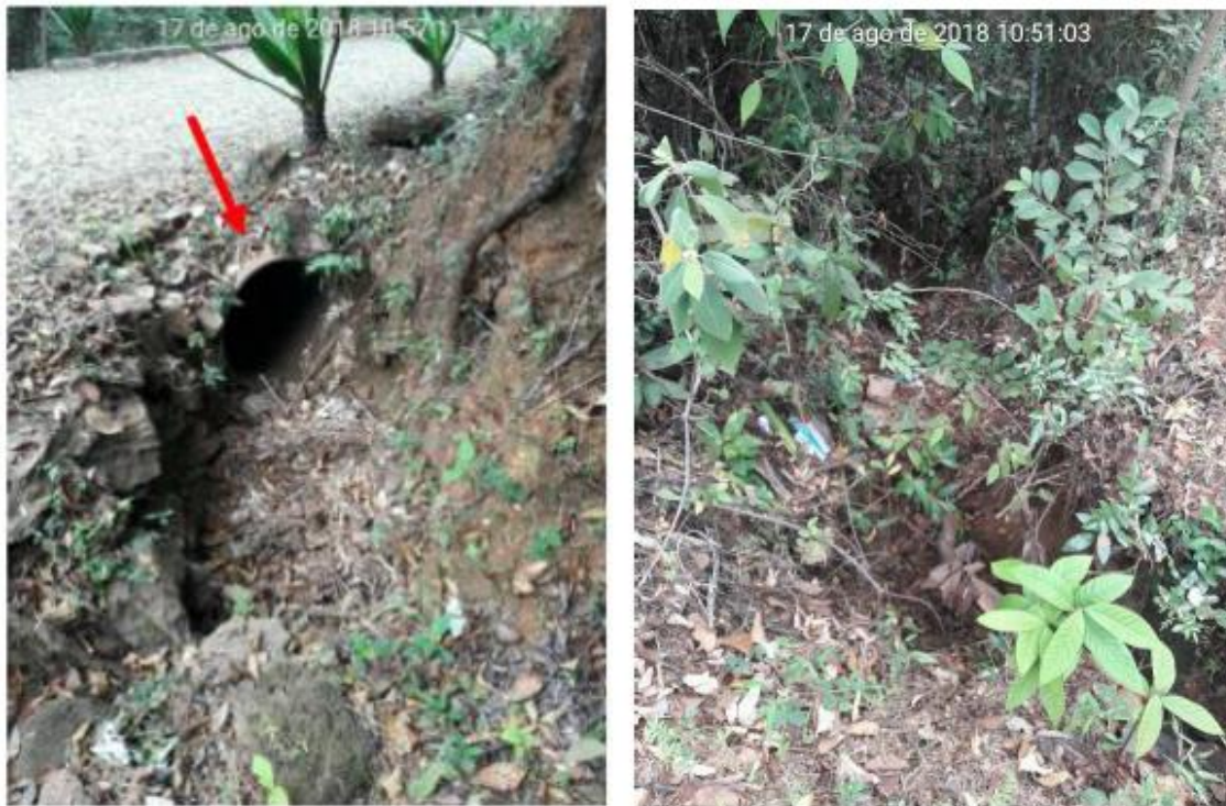
Figura 25 - Erosão linear em Macacos, com destaque para a manilha de drenagem de água pluvial. FONTE: Projeta Engenharia, 2018.
