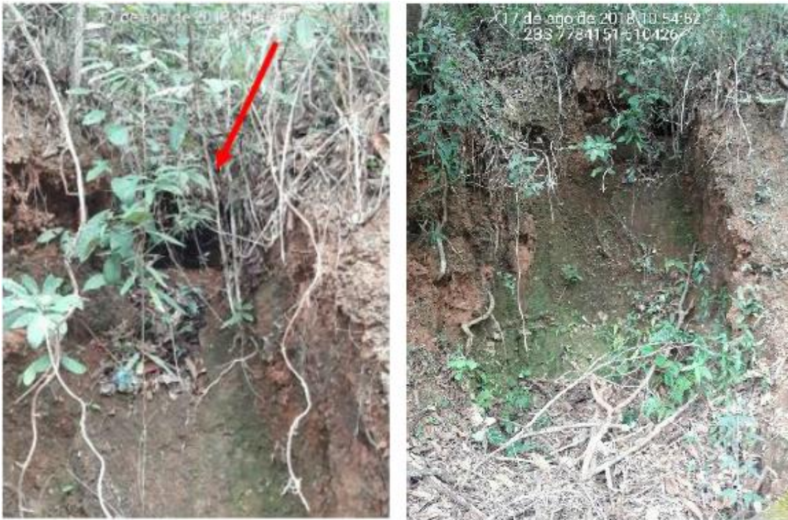
Figura 24 - Erosão linear em Macacos com destaque ao ponto de escoamento pluvial. FONTE: Projeta Engenharia, 2018.
