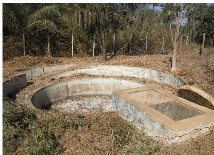
Figura 21 - Leito de secagem de efluente doméstico inoperante no distrito de São José de Almeida (Jaboticatubas). Portal CBH Rio das Velhas, 2016.
