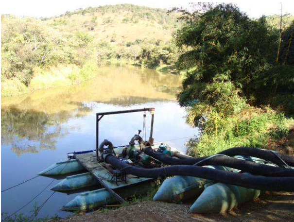
Figura F.69 - Bombeamento para a ETA.
