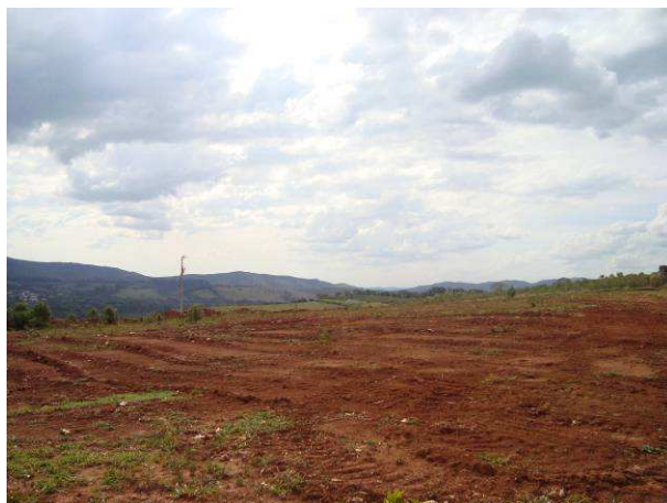
Figura F.91 - Terreno que está sendo preparado para receber a UTC de Conceição.
