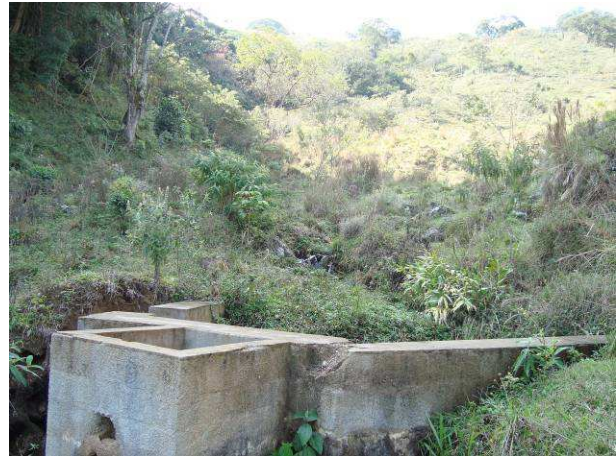
Figura F.38 - Captação no córrego dos Campos.
