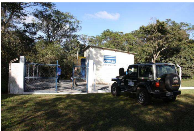
Figura F.169 - Estação de bombeamento da Copasa no ponto de Captação.
