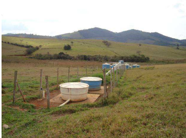
Figura F.149 - ETE compacta dos bairros Nazaré e Vale do Ipê em Conceição.
