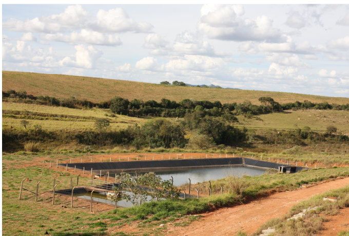
Figura F.178 - Bacias de tratamento do chorume impermeabilizadas com mantas geossintéticas.
