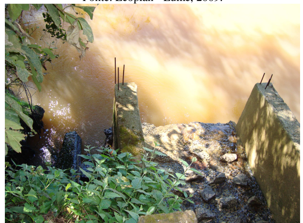
Figura F.122 – Ponto de lançamento da ETE Walita.
