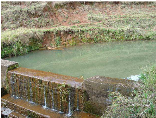
Figura F.61 - Barramento para abastecimento do bairro do Porto.
