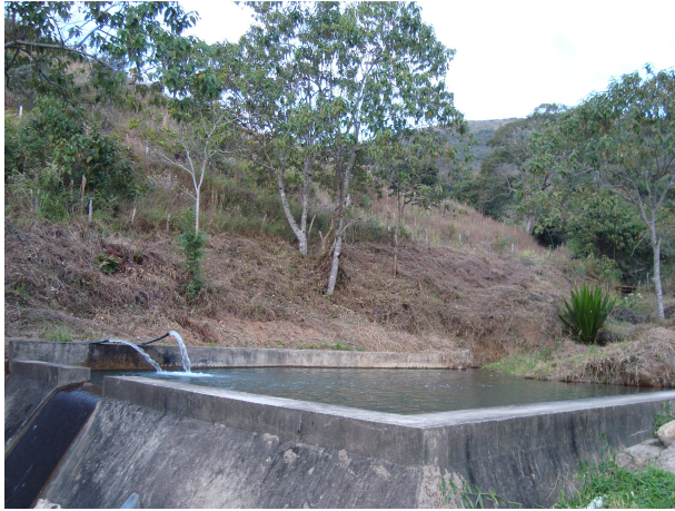
Figura F.41 - Tanque de reservação de água dos dois pontos de captação do ribeirão Bibiria.
