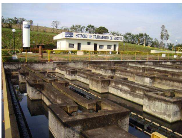
Figura F.103 - Parte do tratamento anaeróbio da ETE da Copasa em Caxambu.
