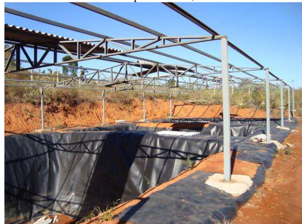
Figura F.195 - Bacias de decantação impermeabilizadas com manta geossintéticas abandonadas e avariadas por vândalos.
