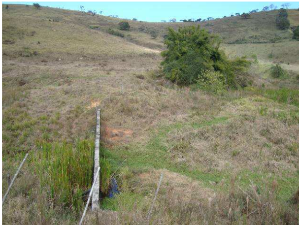
Figura F.81 - Barramento rompido na captação do córrego Paiol de Telha.
