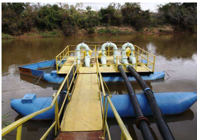
Figura F.111 - Balsa de bombeamento da Copasa.
