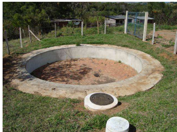
Figura F.15 - Bacia de secagem e sedimentação de resíduos da ETE em operação em São Sebastião do Rio Verde.
