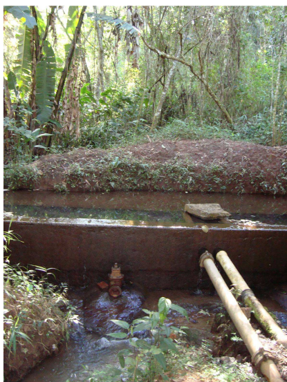
Figura F.93 - Captação no córrego da Covoca.
