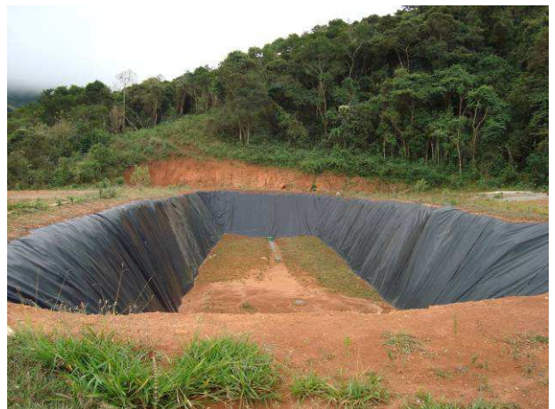
Figura F.34 - Bacia de tratamento aeróbio do chorume assoreada por falta de manutenção.
