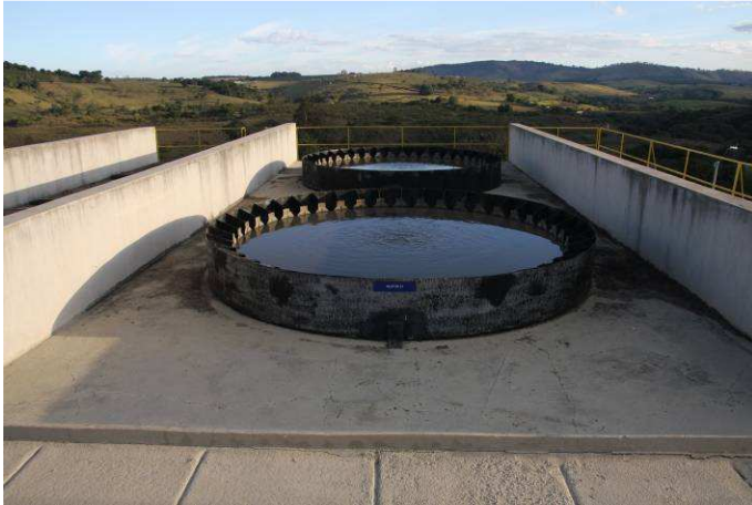
Figura F.125 - Reatores na ETE São José.
