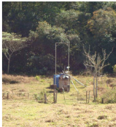
Figura 76 - Poço artesiano que abastece o município de Olímpio Noronha.
