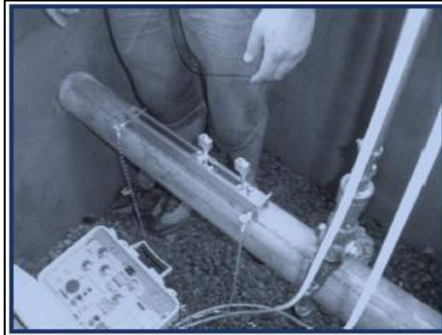
Figura A.14: Medidores de vazão (ultrassônico e medidor diferencial/Pitot)
